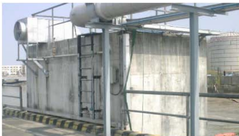
照片 4-7 50\text{m}^3 LNG 泄漏收集池
