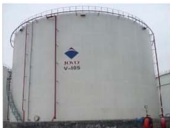
照片 4-5 10000\text{m}^3 事故应急集油罐
