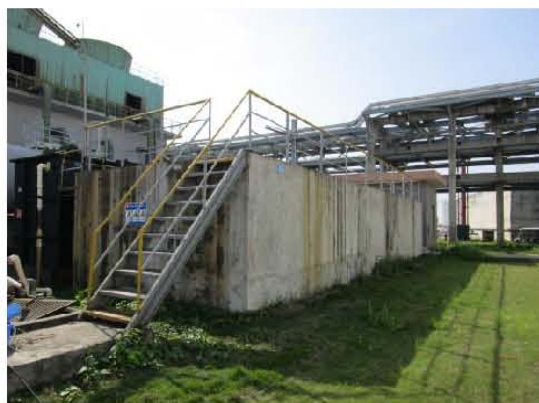
照片 4-2 库区废水处理设施
