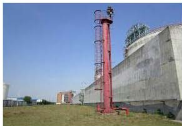
照片 4-4 消防炮塔
